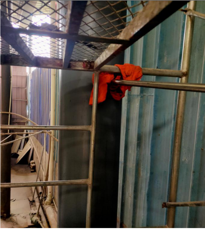
锅炉废气排气筒采样口
