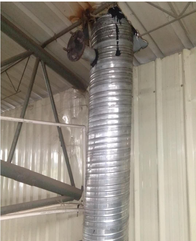
反应釜废气排气筒采样口
