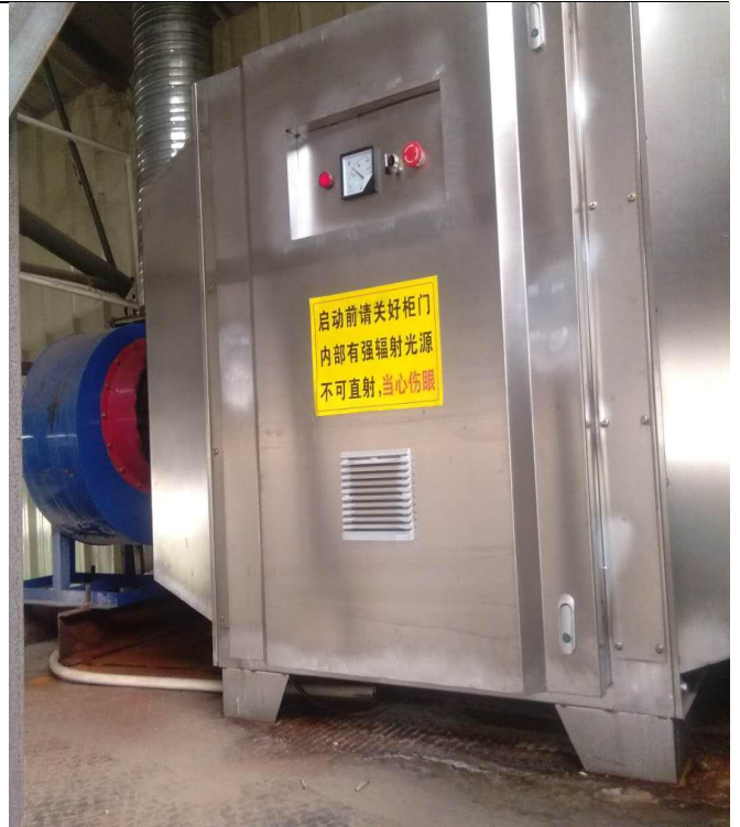
反应釜废气处理装置
