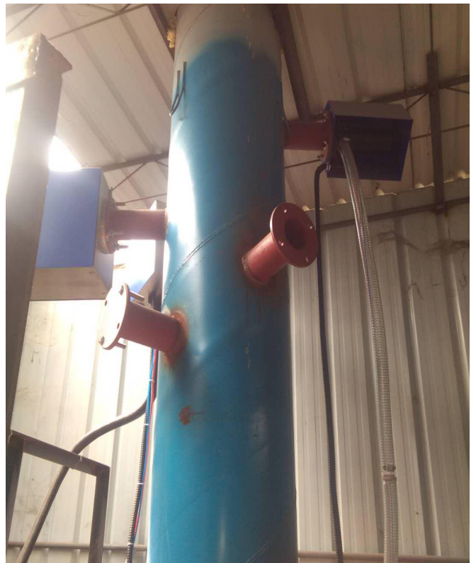
导热油炉废气排气筒监测口
