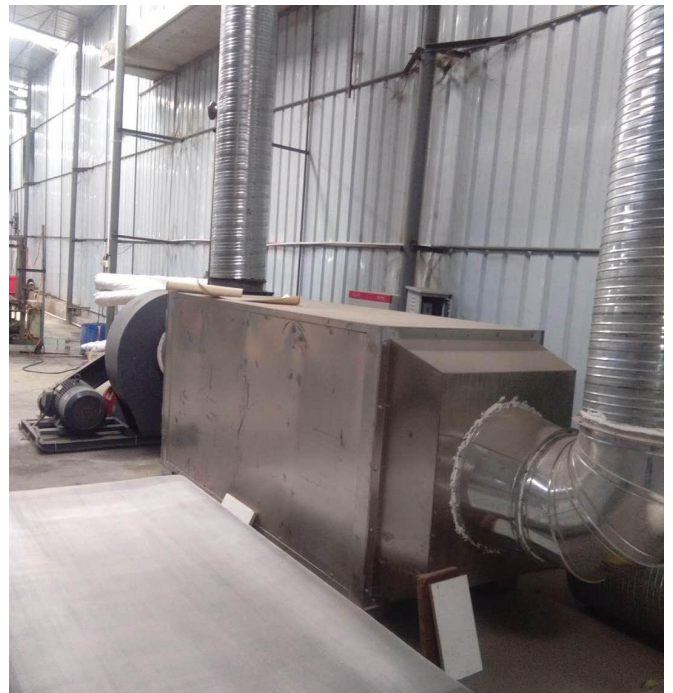
热压工序 UV 光氧+活性炭吸附装置
