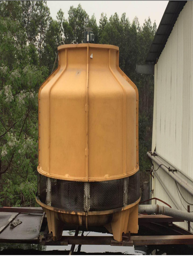
制胶车间喷淋冷却塔
