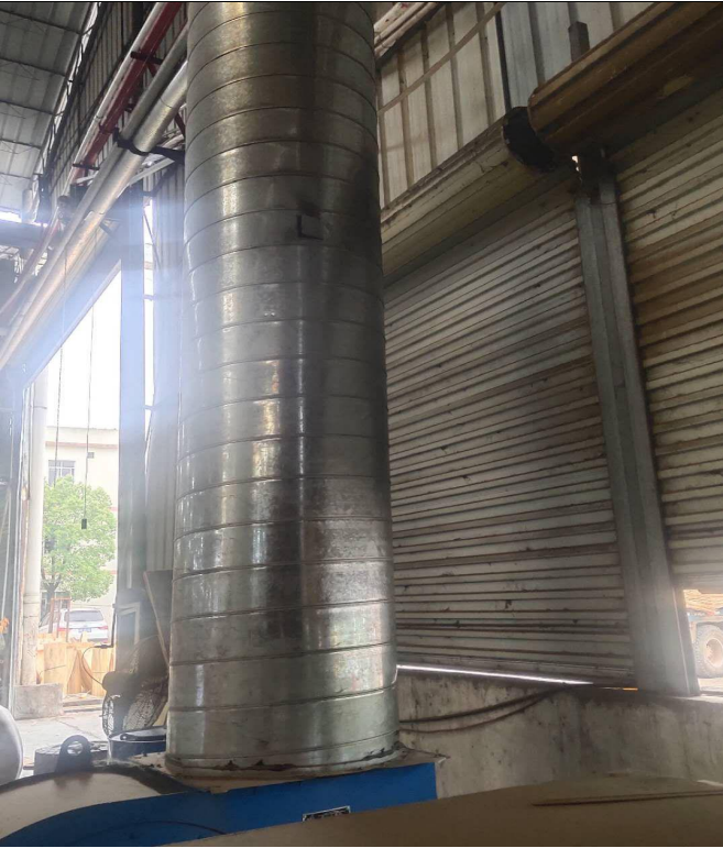
涂胶与热压车间右侧废气排气筒采样口
