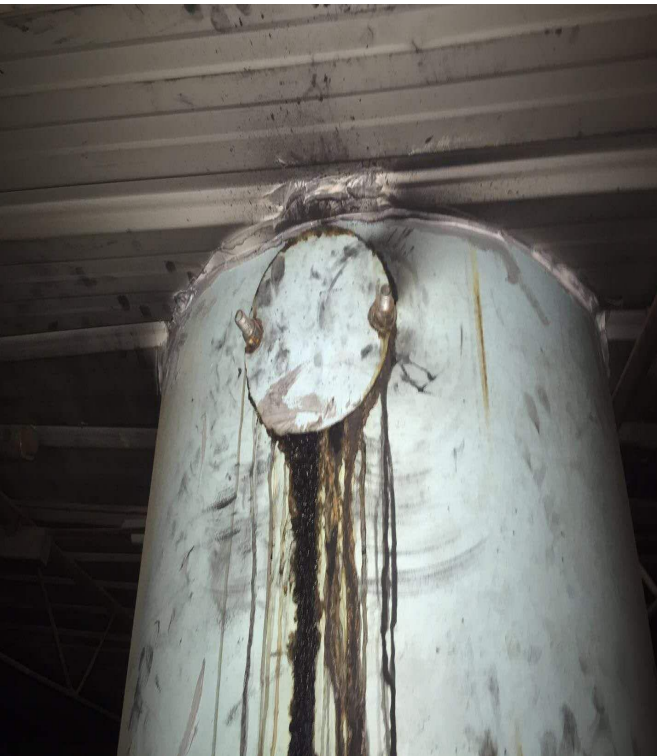
锅炉废气排放口
