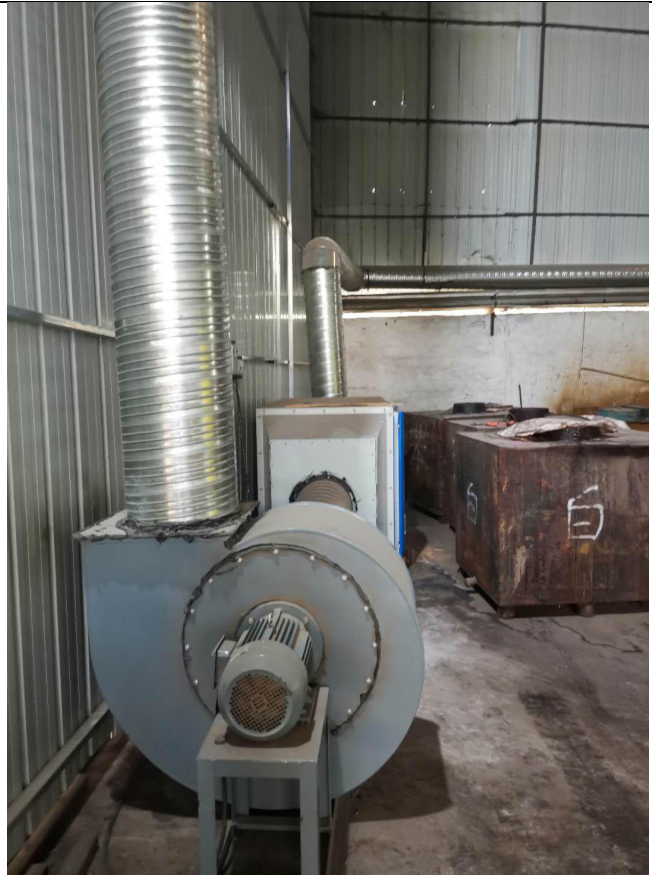
制胶车间废气处理设施
