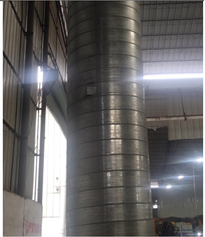
涂胶与热压车间左侧废气排气筒采样口
