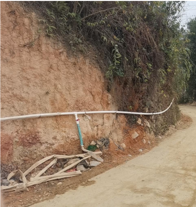
堆场喷水管道
