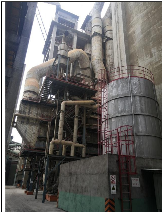
3#和 4#复合脱硫水剂储罐
