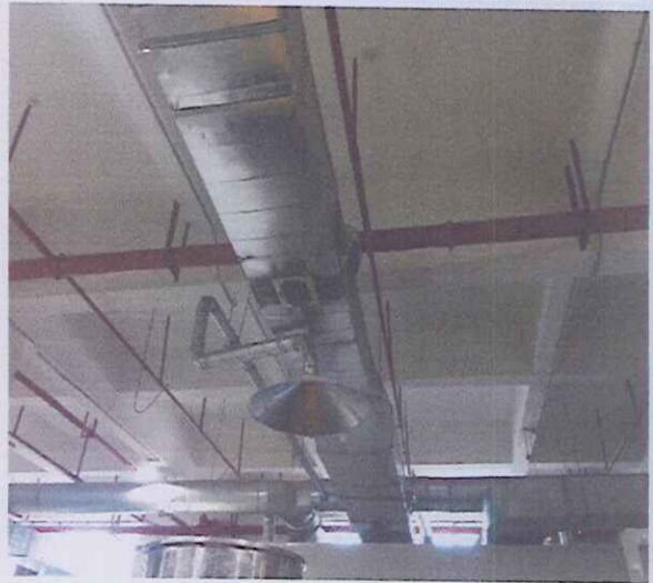
搅拌有机废气集气罩
