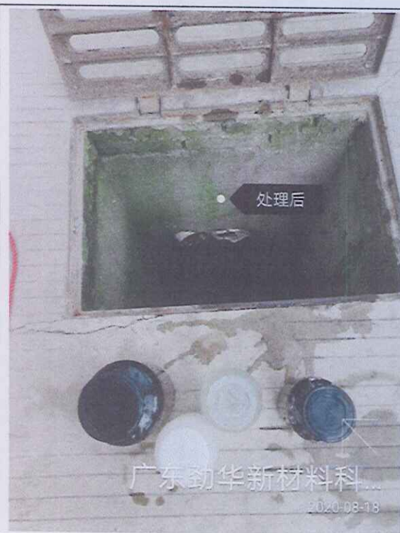
18 日生活污水排口★2#
