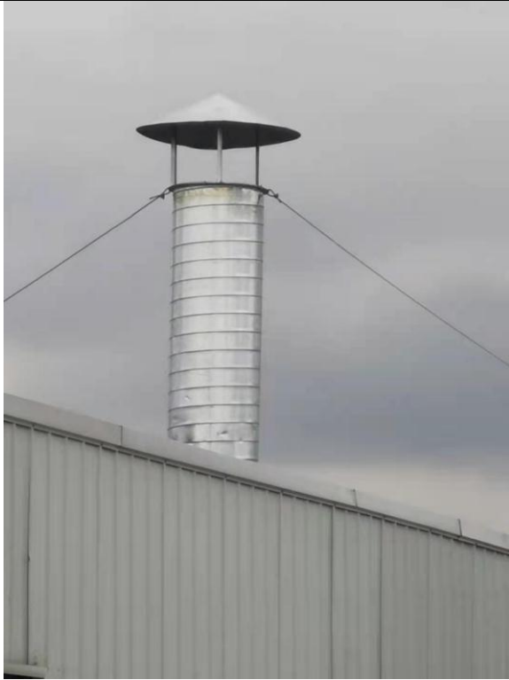
天然气燃烧废气排气筒
