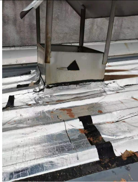
油烟废气排气筒
