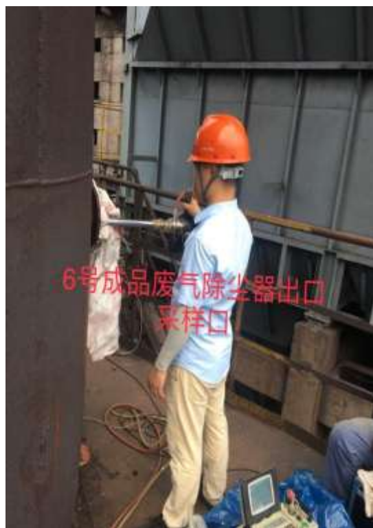
6#成品废气电袋复合除尘器出口采样口
