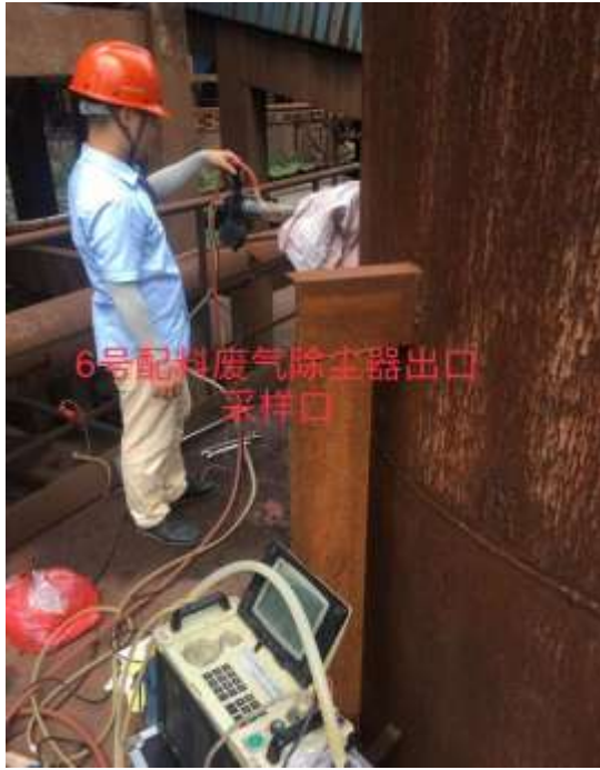
6#配料废气电袋复合除尘器出口采样口
