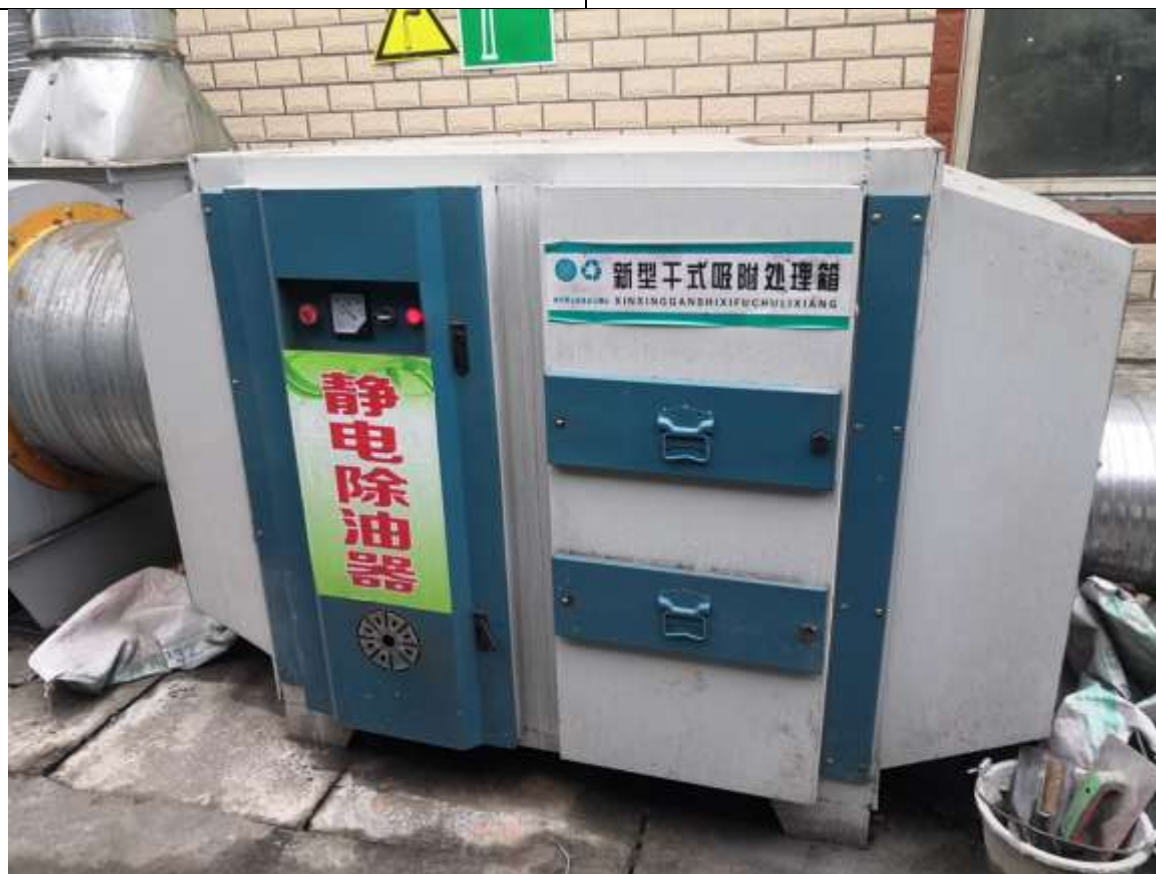
拉丝、割管、造粒废气 水喷淋+静电除油+活性炭吸附+15m排气筒
