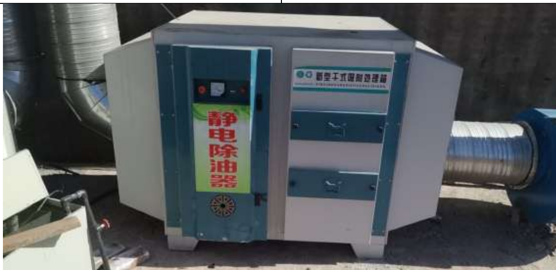
切袋废气 水喷淋+静电除油+活性炭吸附+15m排气筒
