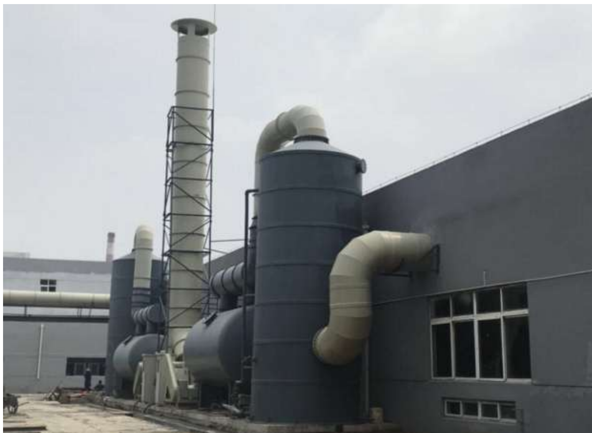
丙一库（含废铁破碎车间）、丙二库废气 “碱液吸收+活性炭吸附”（共2套）+1根15m排气筒
