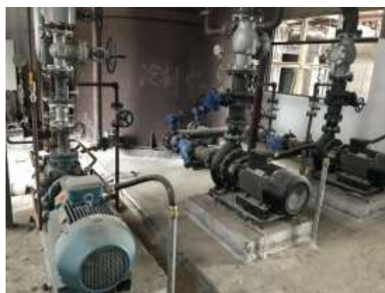
水泵安装在室内
