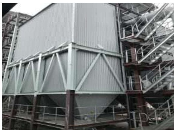
气箱脉冲袋式除尘器除尘
