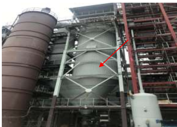
半干式吸收塔（急冷除酸）
