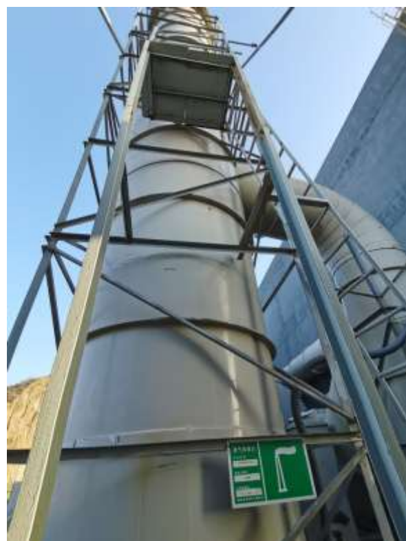
料坑、预处理车间、炉渣烘干及暂存车间废气 15m 排气筒及采样平台
