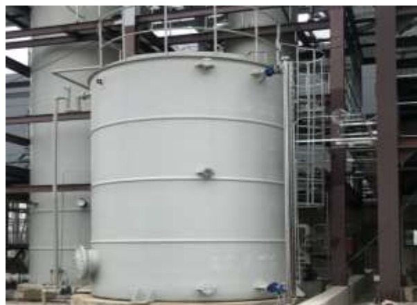
废液收集罐（脱酸）
