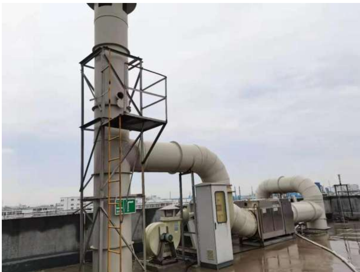
化验室废气 UV 光解+15m 排气筒
