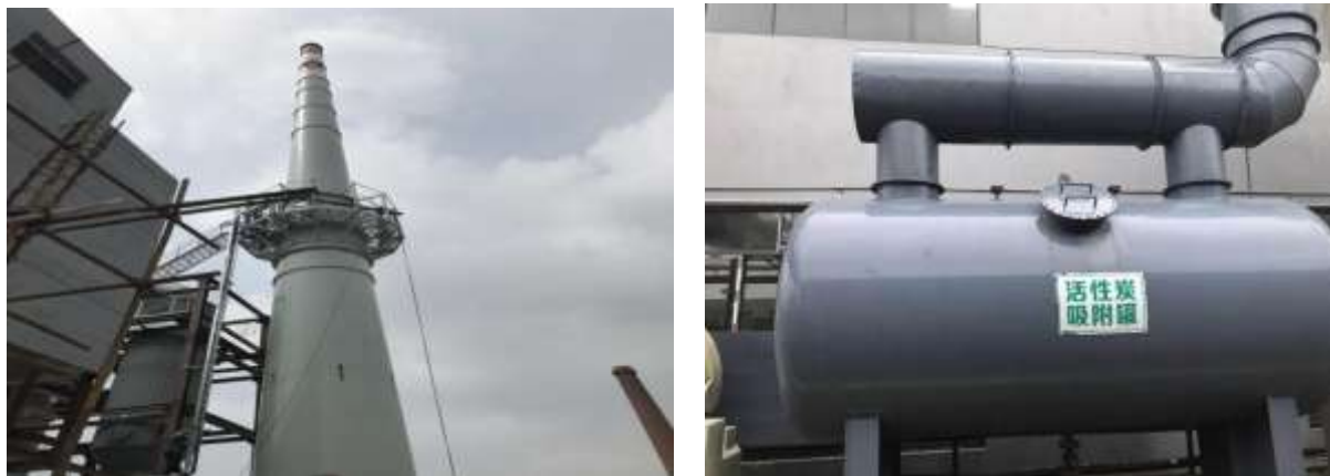
焚烧废气 50m 烟囱采样平台
