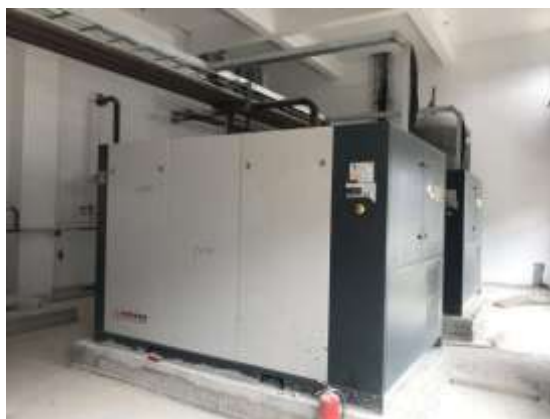
空压机安装在室内
