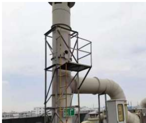
化验室废气 15m 排气筒及采样平台
