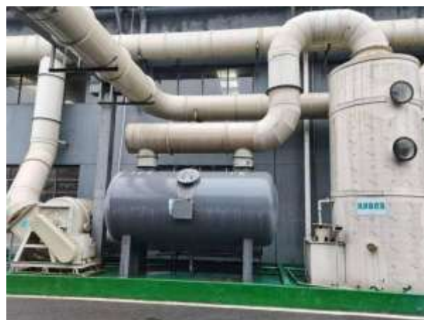
乙B库、炉渣及飞灰暂存库废气 碱液吸收+活性炭吸附
