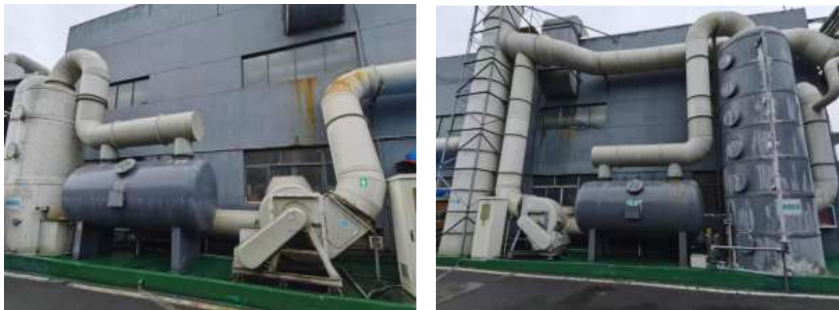
乙 C 库废气 碱液吸收+活性炭吸附
