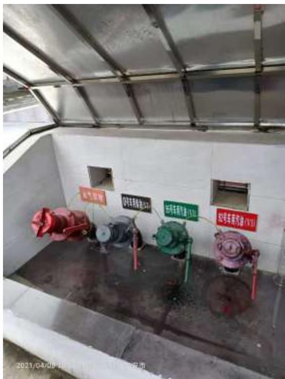
卸油口（卸油油气回收）
