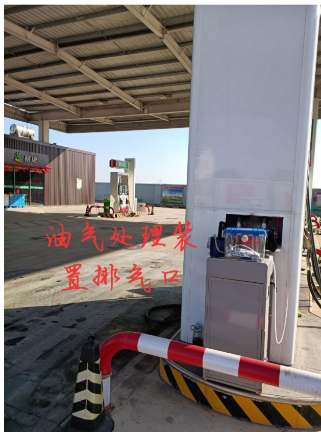
油气处理装置排气口
