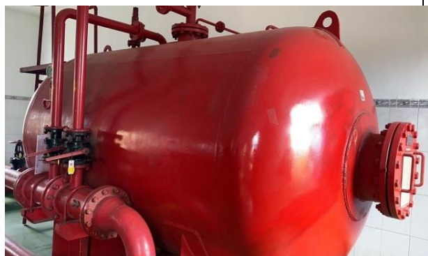
灭火系统泡沫罐
