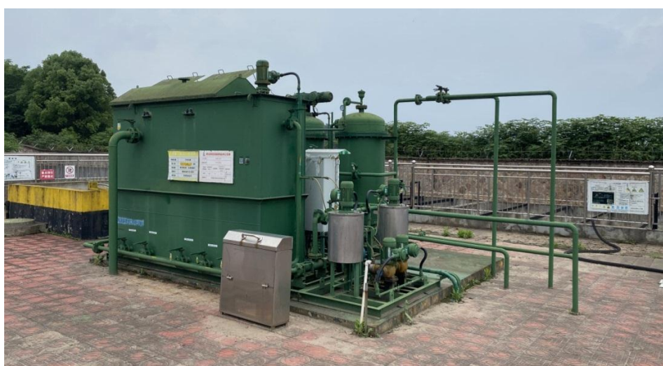
油污水处理设施
