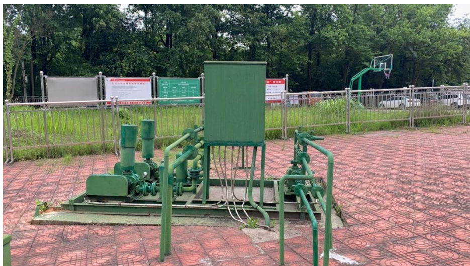
一体化生活污水处理装置
