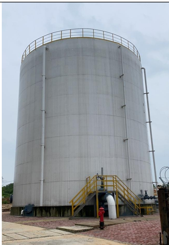
2000 立方消防水罐
