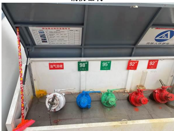
油气回和卸油口
