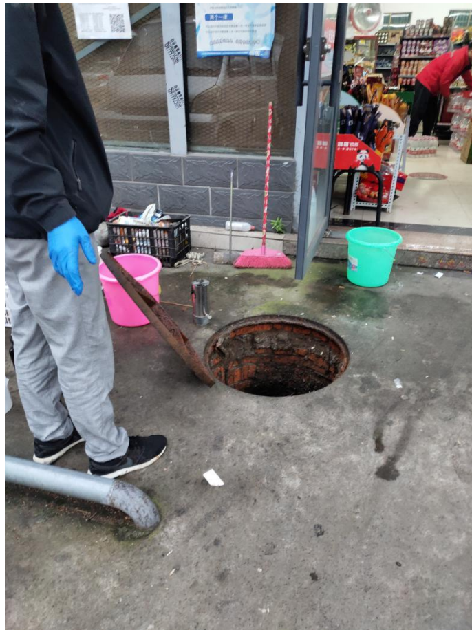
生活污水排放口
