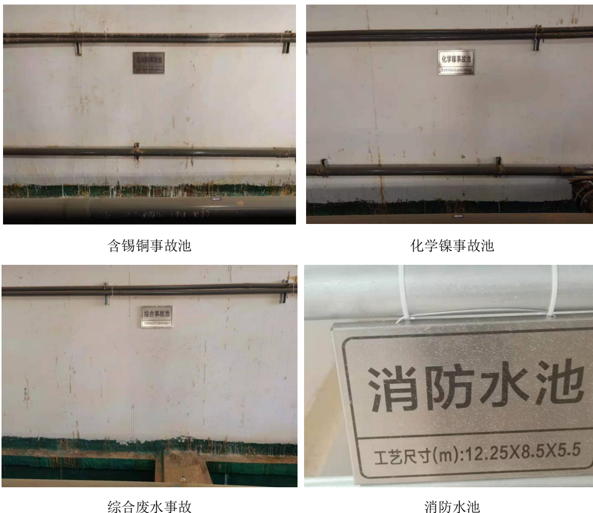
图 4-6 厂区现有事故池、初期雨水池
