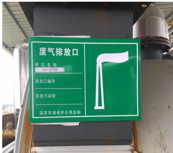
锅炉废气排口标识牌
