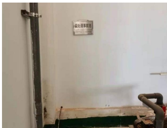
前处理事故池
